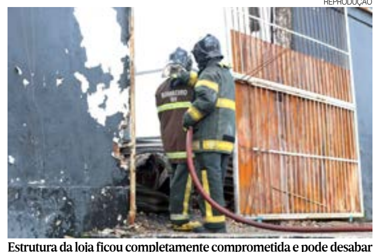
Estrutura da loja ficou completamente comprometida e pode desabar
